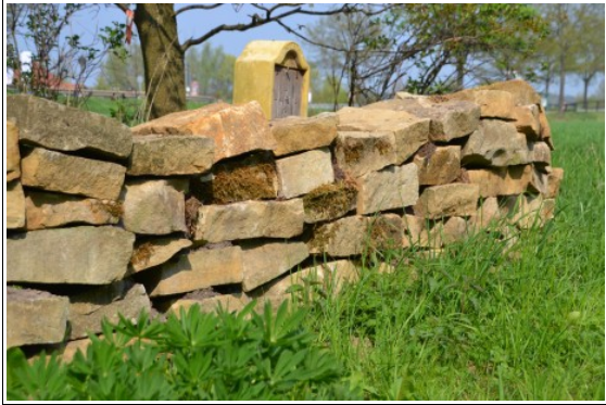
Die Trockenmauer hat im letzten Jahr einen Platz in der Sonne bekommen. Foto: Katja Woidtke
